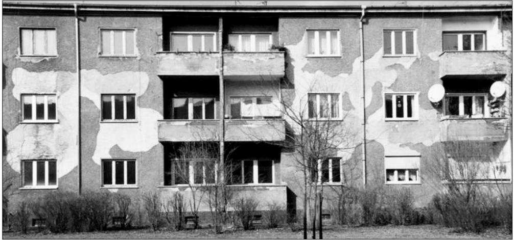
Abbildung 1: Typisches Zeilengebäude mit offensichtlichem Instandhaltungsbedarf im Berliner Stadtgebiet
